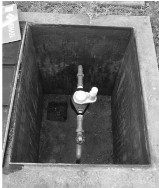
Figura 6. Instalación de medidores volumétricos en entidades universitarias.
