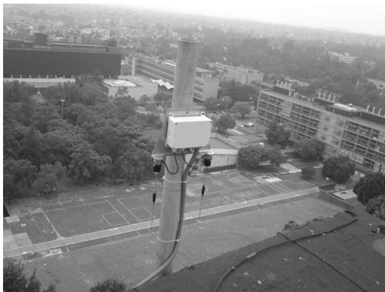
Figura 7. Concentrador instalado en Torre II de Humanidades.
